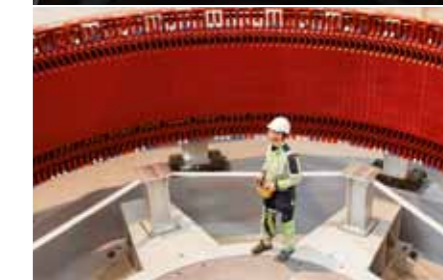
Das Kraftwerk Budarhals wird 2014 mit einer installierten Leistung von 95 MW in Betrieb gehen.
