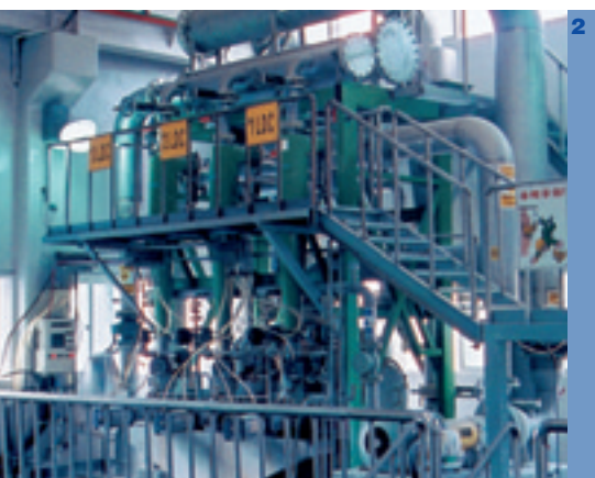
Abb. 3: Loch- und Schlitzsortierung im Vordergrund, im Hintergrund ein Teil der EcoCell-Flotationsanlage.
