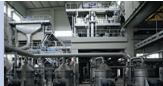
Hinten die Eindickung mit Thune Scheibenfiltern, vorn die Endstufe der LC-Langfaser-Schlitzsortierung.
