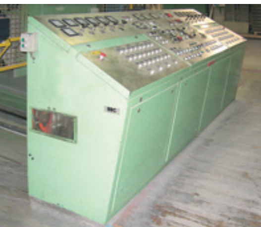
Bedienpult vor dem Umbau
