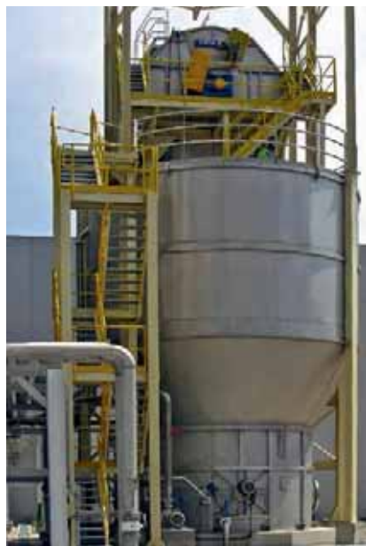
01 Neuer HiConBagless Scheibenfilter, installiert auf dem Stoffturm der Tissuefabrik AMS Gomà Camps in Vila Velha de Ródão, Portugal.
