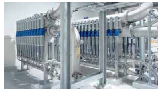
02 Neue HiClean Anlage im Konstanten Teil der PM 7 der Papierfabrik Perlen, Schweiz, ermöglicht geringere Energiekosten und mehr Flexibilität beim Sortenwechsel.
